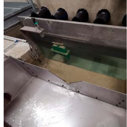
Sickerwasseranlage mit redundanter Durchflussmessung über Ultraschall- und Pegelsonde.
