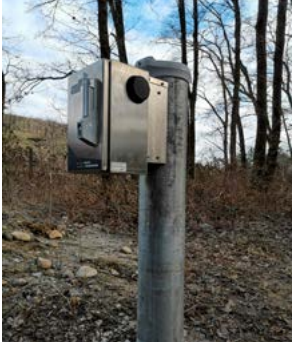
Kompaktbauweise am Pegelrohr der Grundwassermessstelle verbaut mit Akku-Wechselbetrieb
