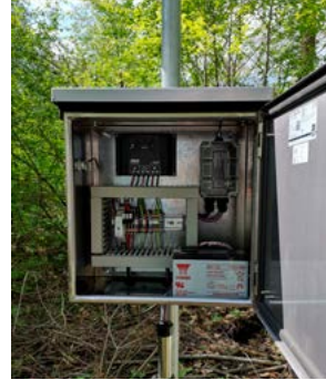
Kompakter und effizienter, leicht wartbarer Systemaufbau im Edelstahlschaltschrank mit Vandalismusschutz
